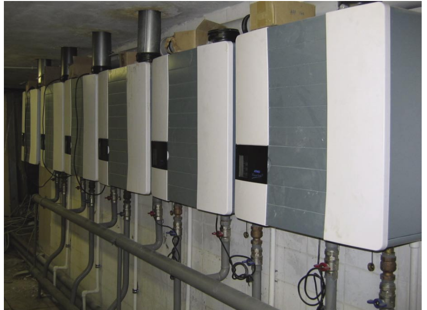
Bahçeşehir Üniversitesi Beşiktaş Kampüsü'nde kurulan 6 + 4 ATAG yoğuşmalı kazanından oluşan toplam 600 kW'lık kaskad ısıtma sistemi.
