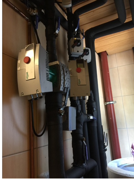
3- Yollu motorlu vana ile gidiş suyu sıcaklık kontrolü
