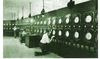
Hava koşullandırma sisteminin yönetildiği kontrol odası.. Stüdyolar dünyanın en büyük hava koşullandırma sistemine sahip. Fotoğrafta, tüm stüdyoların ve binanın diğer bölümlerinin sıcaklıklarını düzenleyen kontrol paneli görülüyor.
