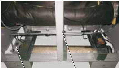
Yoğuşma suyu atma sistemi
