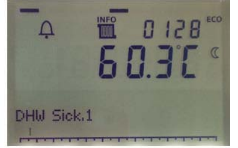
Kullanım Suyu Sıcaklığı
