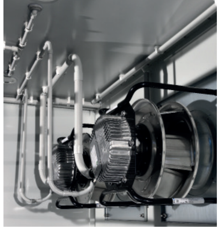
Şekil 22. Güç ve sinyal kablo boruları
