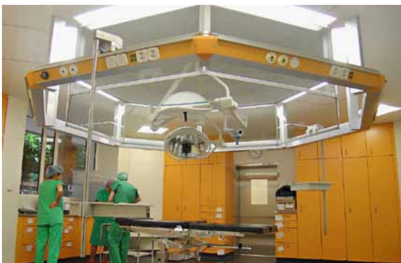
Octagonal laminar flow with octagonal energy supply bridge Oktogonaler Laminar Flow mit oktogonalen Medienversorgungsbrücke CH-Zürich, UniversitätsSpital
