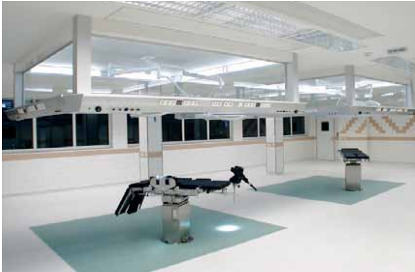
Multiple operating room Grossraum-OP DE-Ganderkesee, STENUM Fachklinik für Orthopädie
