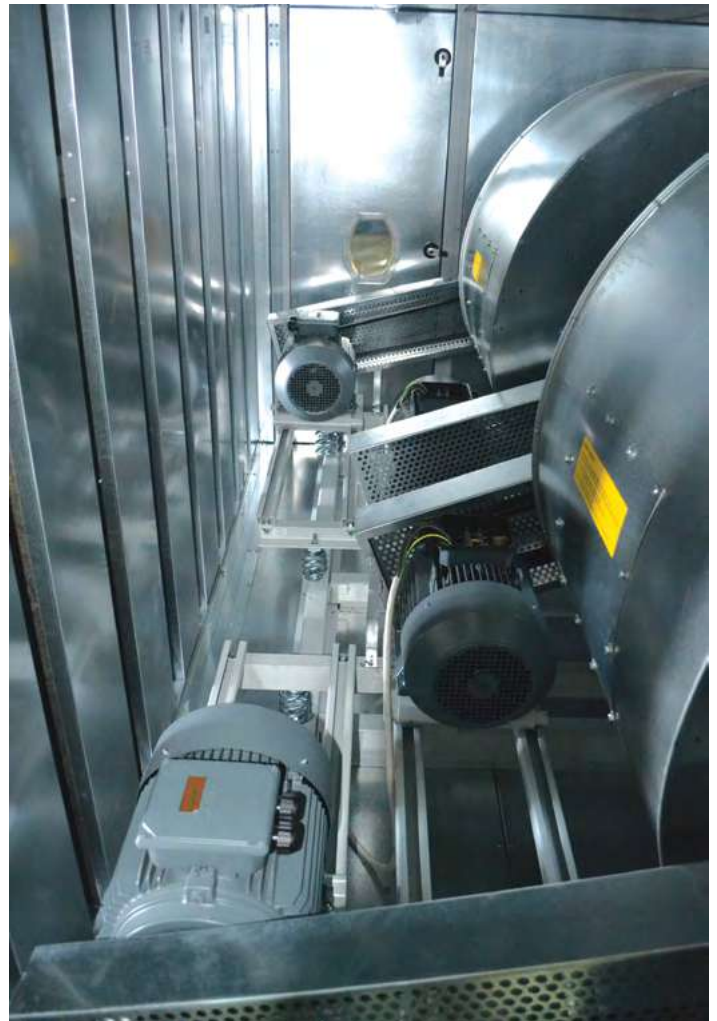
Dual fan and run & standby motor
